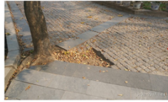
ĐÁ LÁT ĐƯỜNG ĐẠO BỊ BUNG, LỖ => CẦN TÙ SỬA, THAY THỂ
