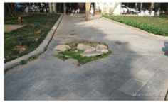
HỖ GẠCH VỠ GỖN GANG GIỮA ĐƯỜNG ĐẠO GÂY NGUY HIỂM
