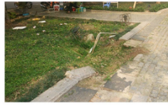
ĐÁ BÓ VÍA BỊ HƯ HỒNG, BUNG, GÂY => CẦN TÙ SỬA, THAY THỂ
