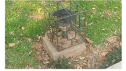
HỆ THỐNG ĐÈN DẪN HƯỚNG BỊ HƯ HỒNG TOÀN BỘ
