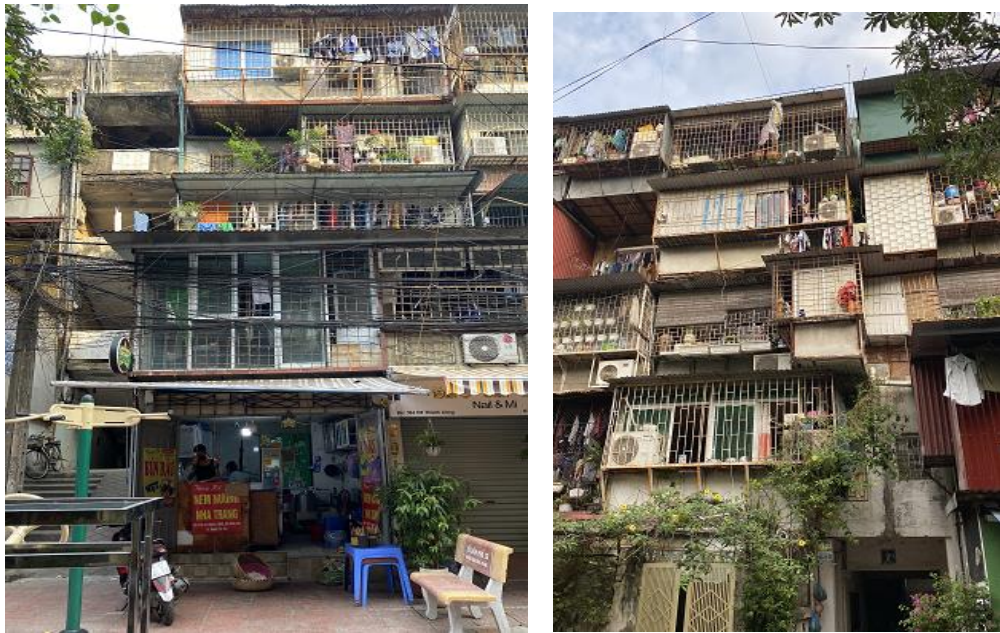
Hình 1.18d. Hiện trạng coi nới tại KCCC Thành Công Hà Nội
