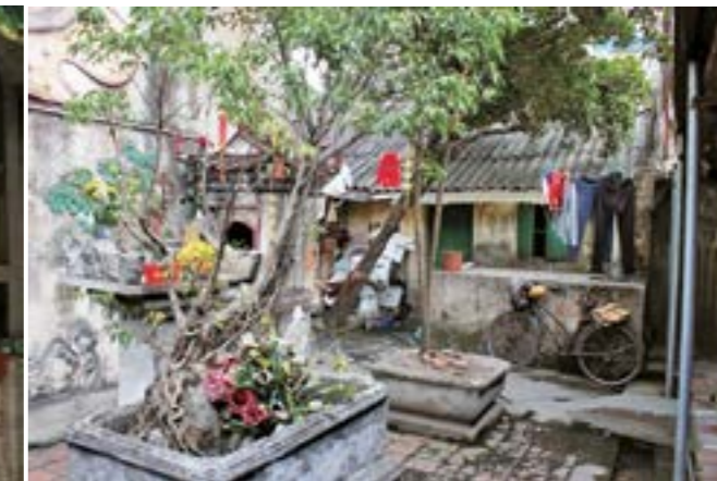
Hình 4. Một góc chùa Thanh Nhàn bị lấn chiếm làm nhà ở và chứa đồ đạc
