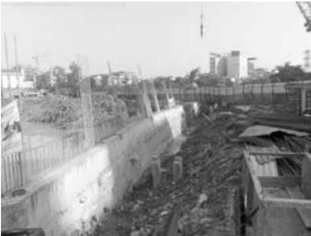
Hình 2. Hình ảnh tường vây bị nghiêng (Nguồn : tài liệu tham khảo[2])
