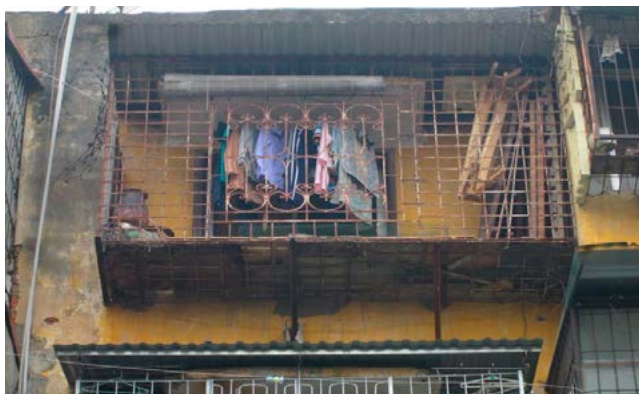
Hình 2. Nhà G6A khu tập thể Thành Công xếp hạng đặc biệt nguy hiểm, đơn nguyên 1 và 2 bị sập lún, tách ra làm đôi. (Nguồn Internet)
