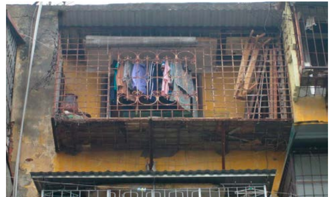
Hình 3. Dãy nhà cũ khu tập thể Thành Công xuống cấp, oằn mình gánh tứ bề chông cọt đã hoen rỉ. (Nguồn Internet)
