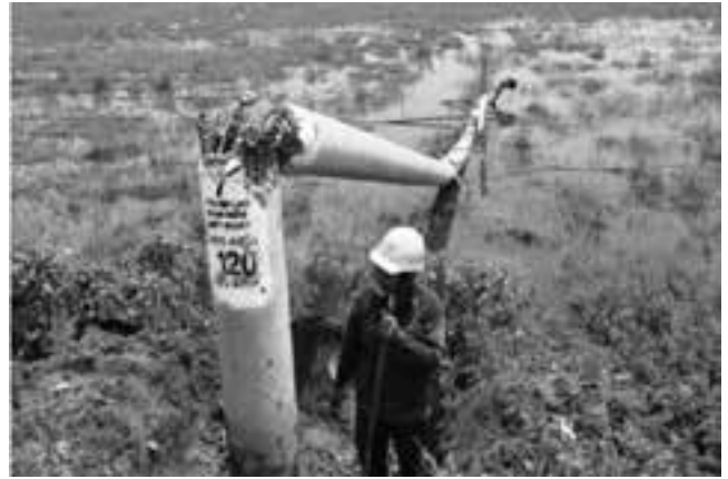
Hình 2. Cột điện bị gãy tại Quảng Bình
