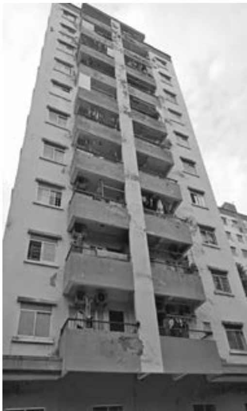
Hình 3. Sự xuống cấp của một tòa nhà chung cư xây 2002
