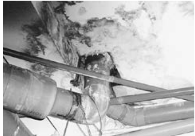
Hình 2. Ống thoát nước bị rò rỉ gây thấm dột
