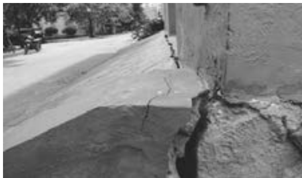
Hình 5. Sụt lún tại khu nhà tái định cư sau 5 năm sử dụng
