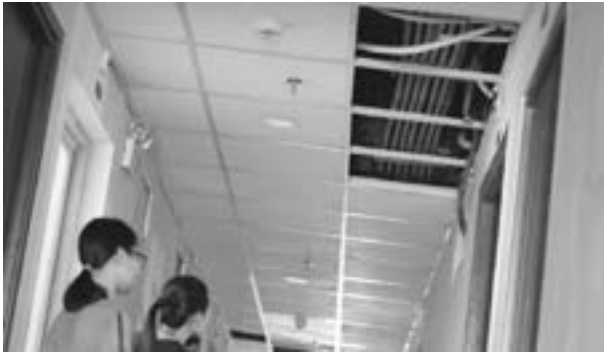
Hình 1. Hệ thống cấp nước bị rò rỉ ở một chung cư
