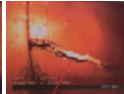
Cống bị nứt nhỏ
