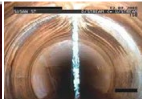
Cống bị nứt to
