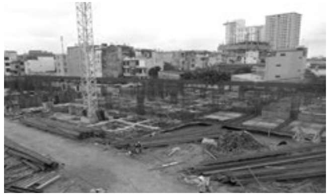
Hình 1. Ảnh công trình có mặt bằng xây dựng chật hẹp
