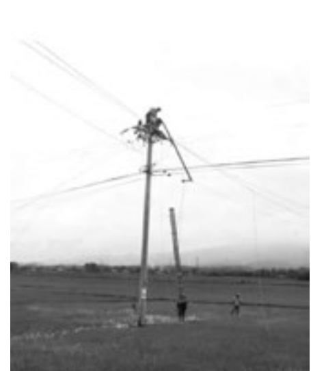
Hình 4. Sự cố khi thi công trên cột
