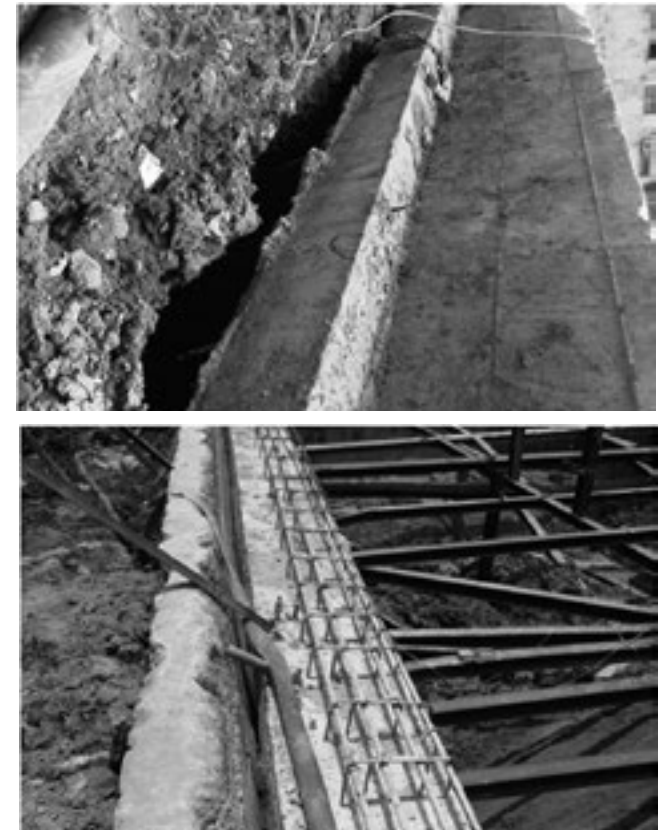
Hình 1. Sự cố tại công trình Intracom II - Cầu Diễn
