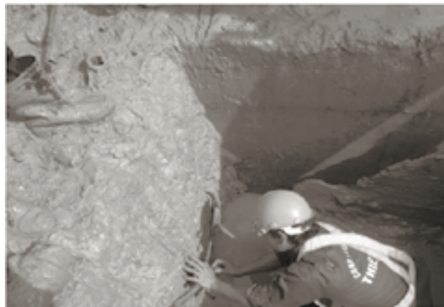
Hình 6. Sự cố không hạ được lồng thép do vướng thép của cọc kế bên
