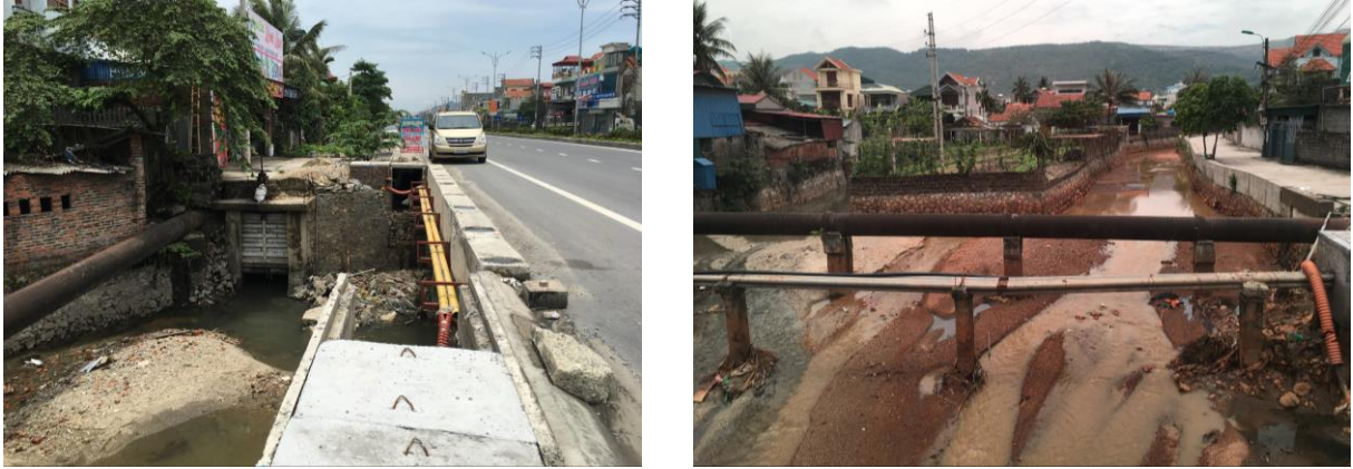
Hình 3.7: Hiện trạng hệ thống thoát nước Thành phố Cẩm Phả
