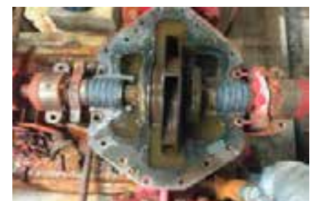
Hình 3. Bơm bị gỉ sét phía trong
