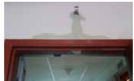
Hình 1. Đầu phun hệ thống chữa cháy bị rò rỉ
